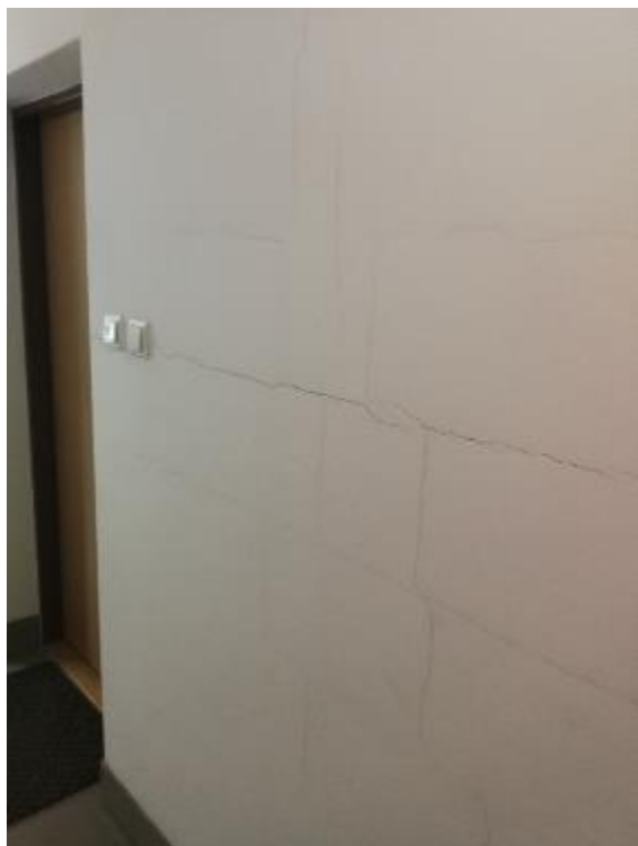
Zdjęcie 13. Przykładowe spękania tynku
